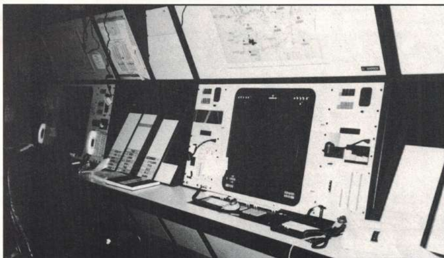
Paneles de Control en las instalaciones de "Carrasco Radar" donde se recibe la información de rastreo de aeronaves
